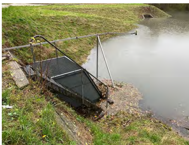
Figur 5. Niveau-målers placering over det primære udløb. Billede taget 16. november 2023 (3. største niveau på Figur 7) på et tidspunkt hvor bassinet var ca. 45% fyldt. Ved regnhændelsen faldt i alt 38,2 mm over 892 minutter
